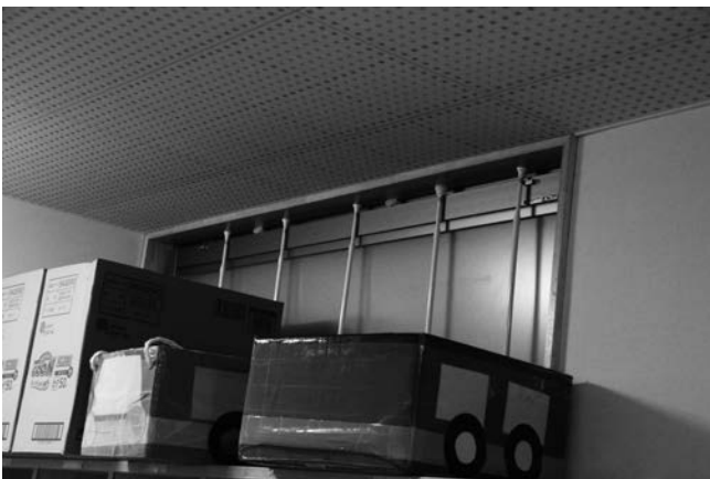
すでに報告が上がっている園舎被害は職員が応急処置で対応している。隣家が倒れてきて壊れてしまった排煙窓は閉まらないので突っ張り棒でおさえている。
