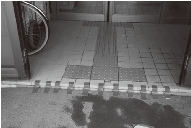
コンクリートがゆがみ、段差ができてしまったところに目印としてテープが張られている。
